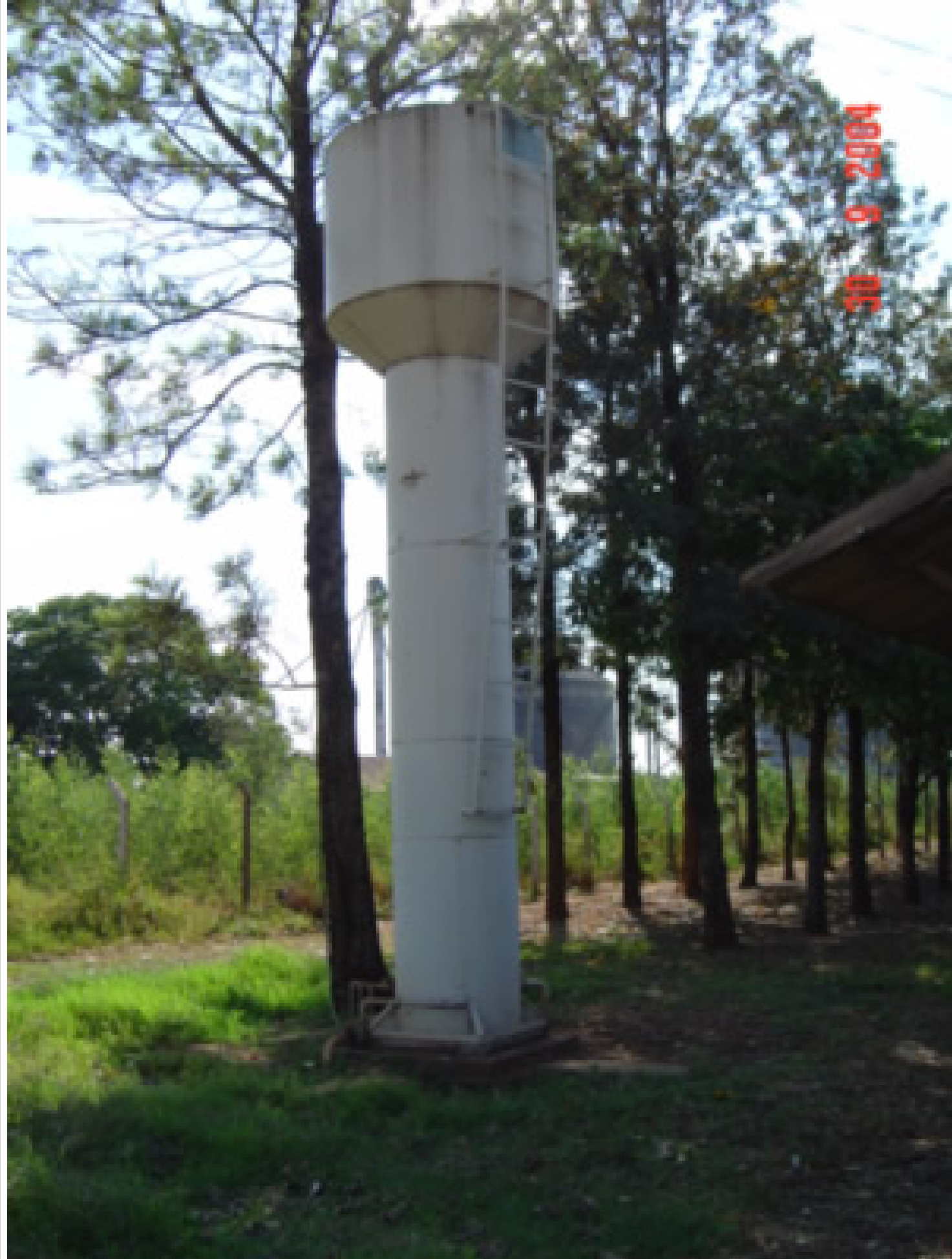
Caixa fechada, usada como reservatório principal, que conserva melhor a qualidade da água
